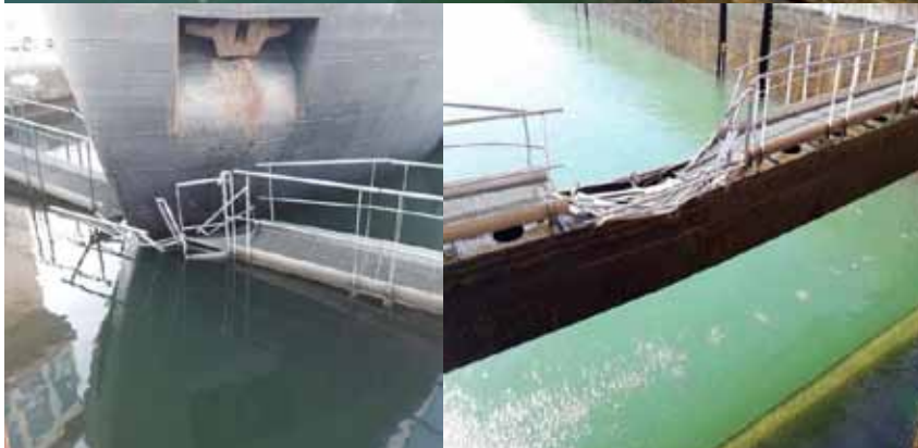
Bilder der Schäden in den Schleusen von Gerstheim und Rhinau nach den beiden Zwischenfällen im März 2019. Fotos: EDF.
